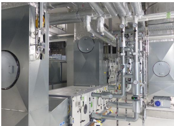
Lüftungsanlagen mit Wärmerückgewinnung im Neubau des Klinikums Frankfurt Höchst. Zudem verfügt jeder Operationssaal über eine eigene Lüftungsanlage. © PHI
