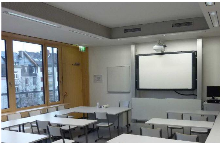
Ziehenschule in Frankfurt/Main: Die Passivhaus-Schule kann durch ihre Lüftungsanlage mit Wärmerückgewinnung auf das vom Umweltbundesamt empfohlene vermehrte Stoßlüften verzichten. Die Lüftungsanlage sorgt automatisch für frische Luft. © Passivhaus Institut
